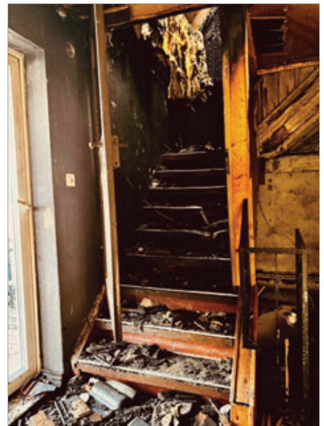
So sieht der Treppenaufgang vom Erdgeschoss in das erste Obergeschoss nach der Brandbekämpfung aus.
